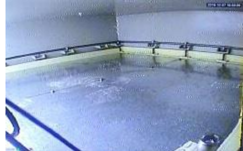
风压箱中的实时监控系統
